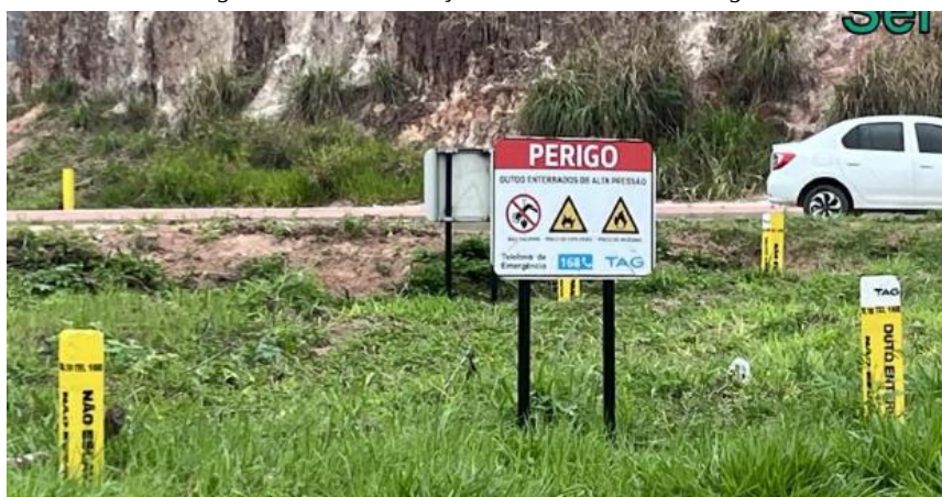
Figura 2.3-24: Sinalização indicatória da rede de gás
