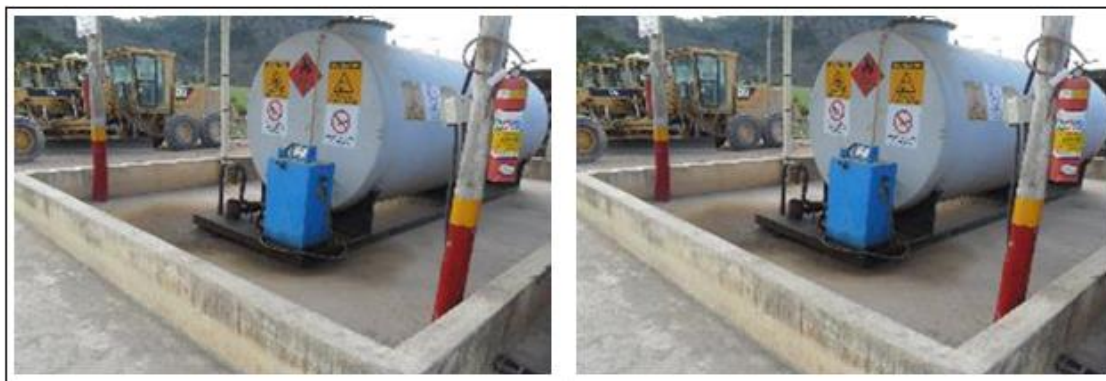
Figura 2.4-7 Exemplo de tanque de abastecimento
