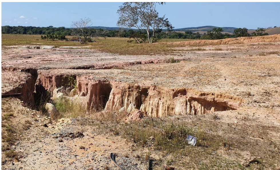
Foto 29 – Processo Erosivo em Cambissolo
