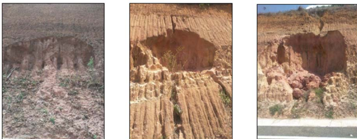
Figura 28 – Tipificação de Processos Erosivos
