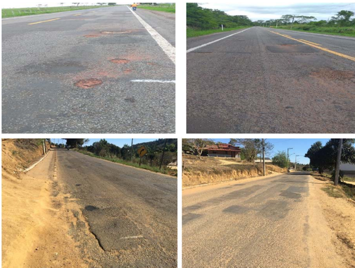
Foto 1 – Condição de Pavimento Existente – Defeitos (Remendo, painelas e desgastes)
