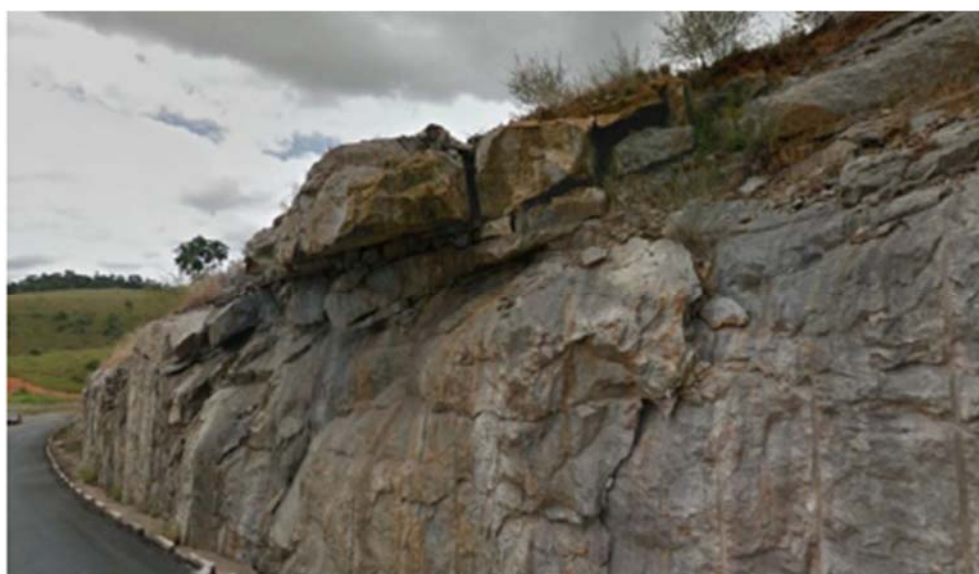
Foto 22 – Rocha Fraturada – Estaca 219 a 220 – ES 248 (Lado Esquerdo)
