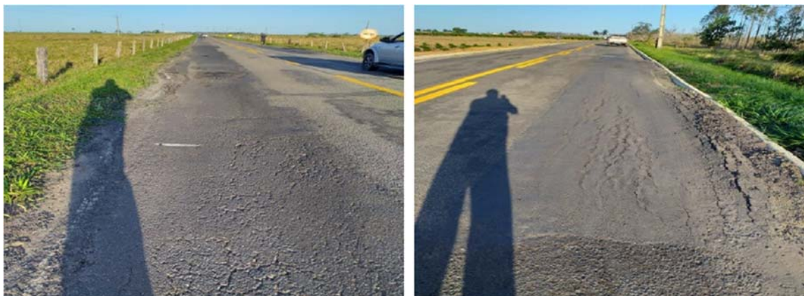
Foto 2 – Condição de Pavimento Existente – Defeitos (remendos, “jacaré” e deformação plástica)
