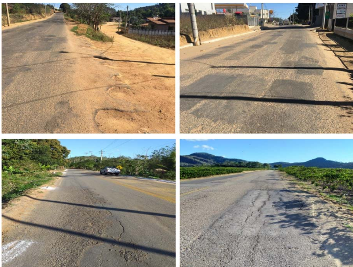
Foto 3 – Condição de Pavimento Existente – Acesso e remendos
